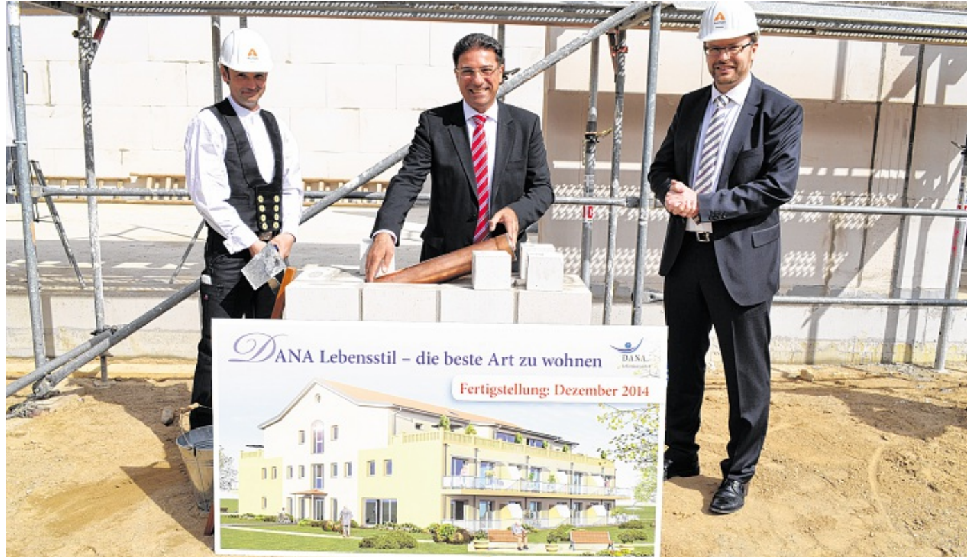
Legten gestern den Grundstein für das Wohnprojekt im Meinsdorfer Weg: Michael Harks (Polier der Firma Altus Bau), Yazid Shammout (Dana-Geschäftsführer) und Thomas Becker (Geschäftsführer der Firma Altus Bau). JULIAN HELDT
